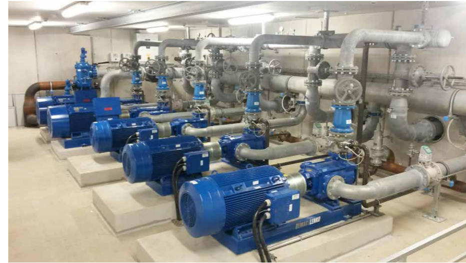
5 Hochdruckpumpen von Caprari mit Siemensmotoren und Rückspülfilter.
